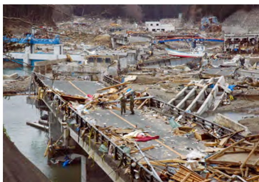
▲ 歌津地區伊里前的國道 45 號公路的橋樑全毀。 照片提供 陸地自衛隊北部方面小隊
