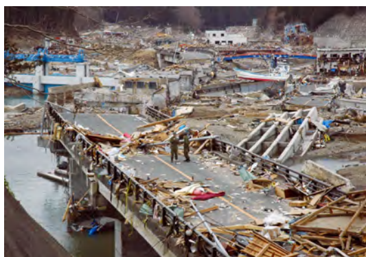
▲歌津地区伊里前の国道 45 号の橋は津波で全壊した。 写真提供 陸上自衛隊北部方面隊
